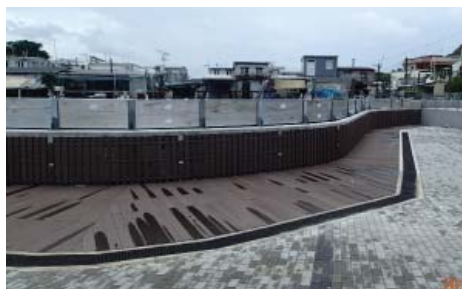
大澳的可拆卸式防洪裝置
