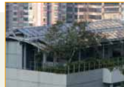
屋頂太陽能光伏板將太陽能轉化為電能，供樓宇使用
