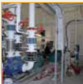
消防花灑和消防裝置泵房
