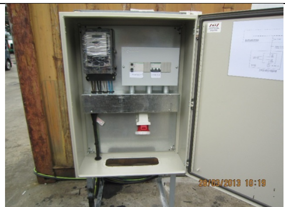
EV-2 – 天水圍修車場的充電站
