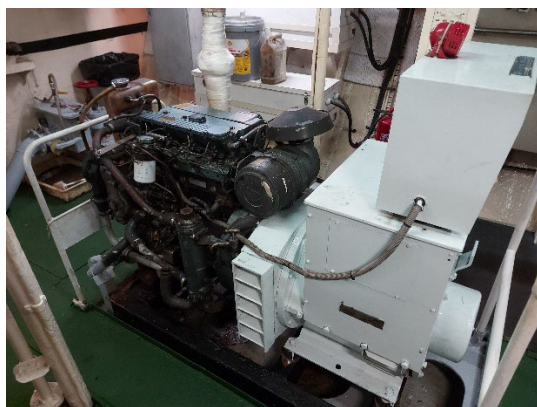
輔助發電機組
