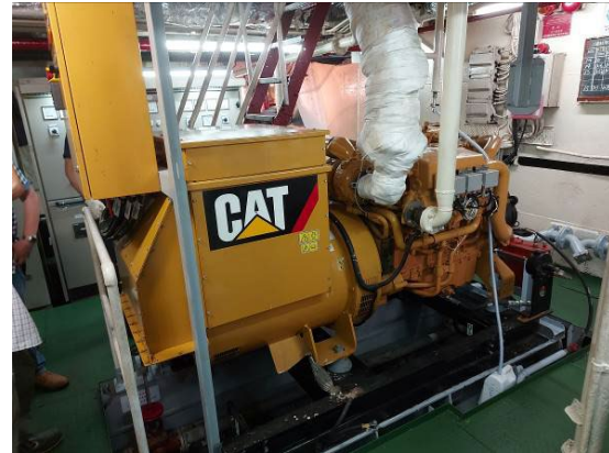
2 號主發電機組 (驅動用)
