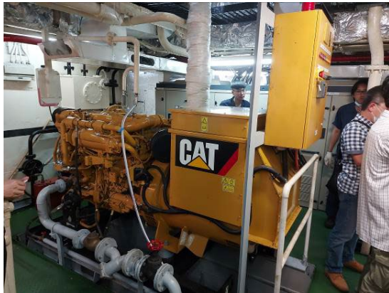
1 號主發電機組 (驅動用)
