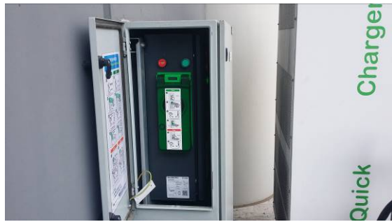
充電設施 (由香港機場管理局安裝在機場內)
