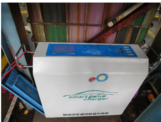
3 相 30 千瓦直流充電設施 1 (EV1)
