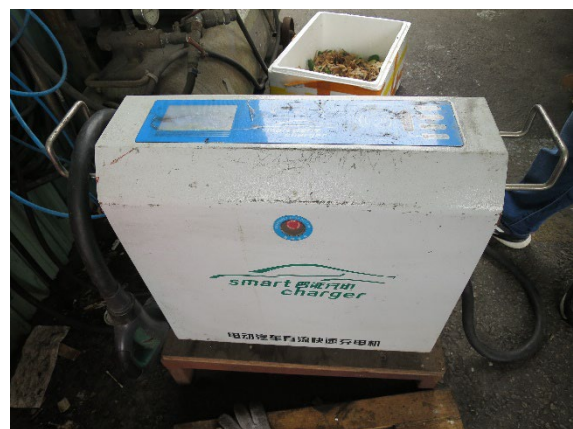
3 相 30 千瓦直流充電設施 2 (EV2)
