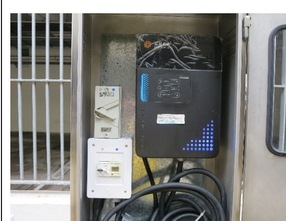
7 千瓦單相交流充電設施
