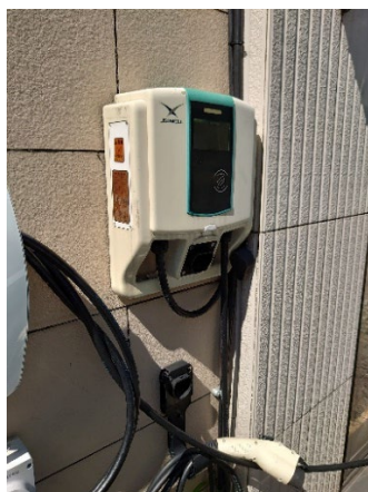
7.4 千瓦單相交流充電設施 (參與機構自資安裝)
