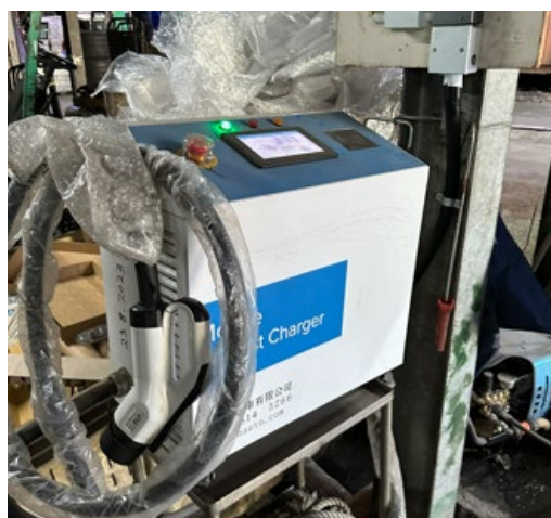
30 千瓦直流充電裝置 #1
