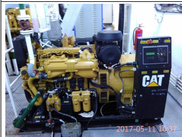
輔助發電機組
