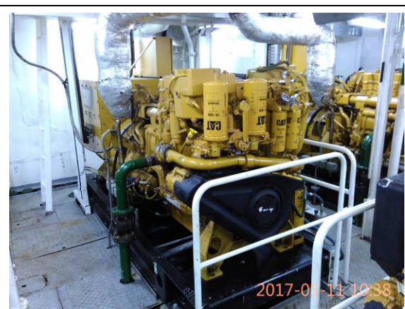
2 號主發電機組(驅動用)
