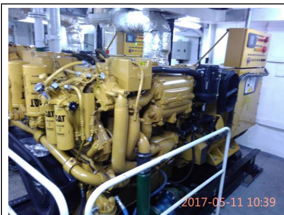
1 號主發電機組(驅動用)
