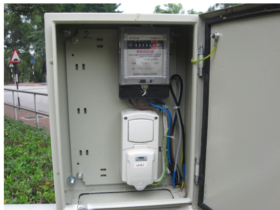
EV-1 充電設施的電度錶
