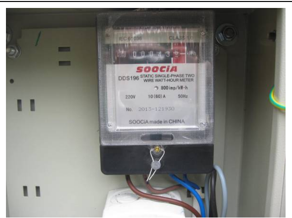
EV-2 充電設施的電度錶
