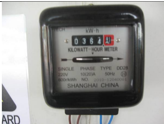
EV-2 充電設施的電度錶
