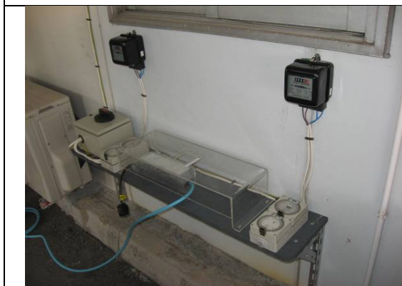
電動客貨車的充電設施
