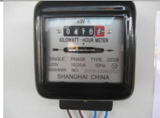
EV-1 充電設施的電度錶
