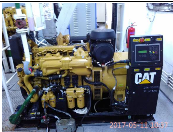
輔助發電機組
