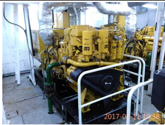
2 號主發電機組(驅動用)
