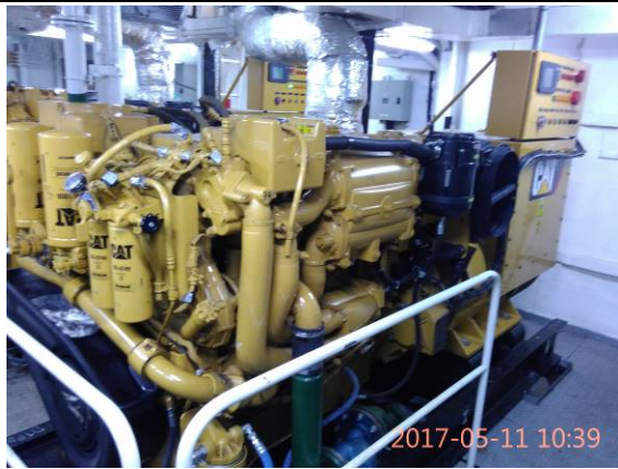
1 號主發電機組(驅動用)
