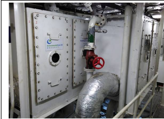
洗滌器和排氣管
