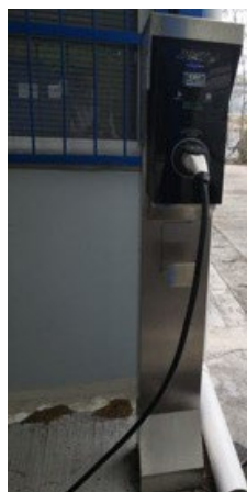
充電設施 1 (主要為電動貨車 1 充電)
