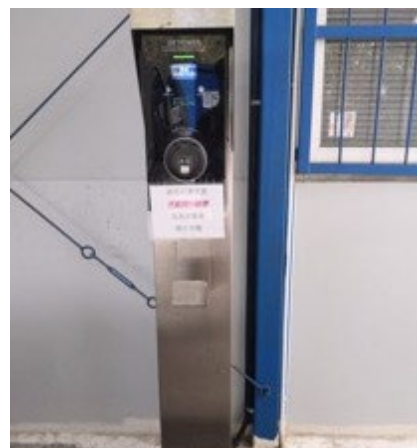
充電設施 2 (主要為電動貨車 2 充電)
