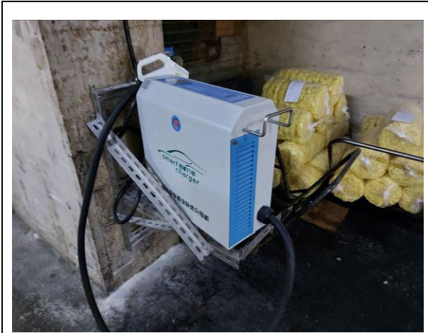
30 千瓦直流充電設施
