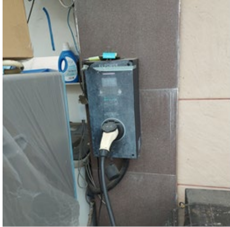
EV-1 – 充電設施 (5/10/2021 起使用)
