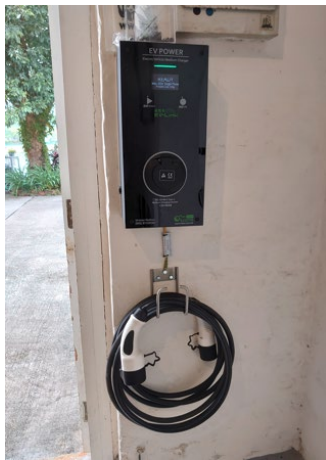
7.4 千瓦單相交流充電設施 (參與機構自資安裝)
