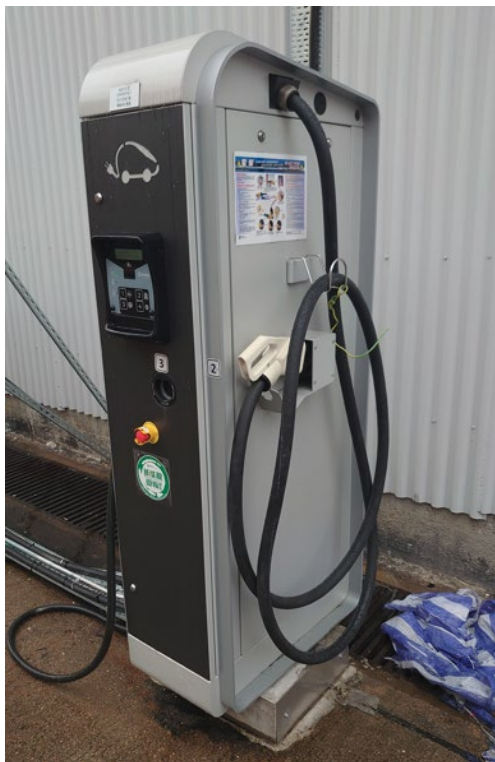
位於 2 號貨櫃碼頭的 50 千瓦直流快速充電裝置
