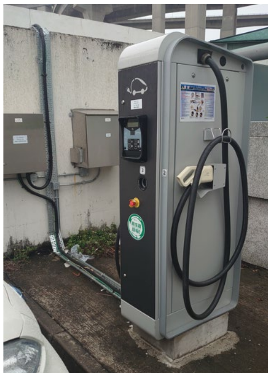
位於 9 號貨櫃碼頭（南）的 50 千瓦直流快速充電裝置
