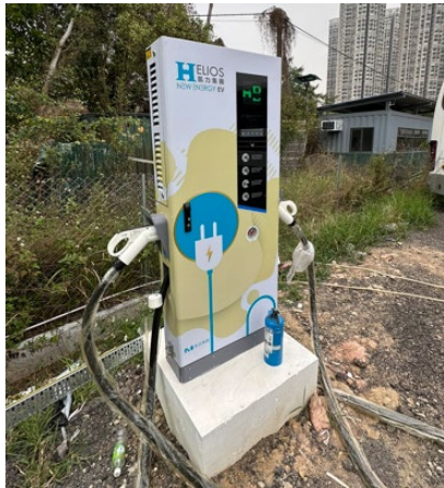
在天水圍停車場的 60 千瓦直流充電設施（參與機構自資安裝）
