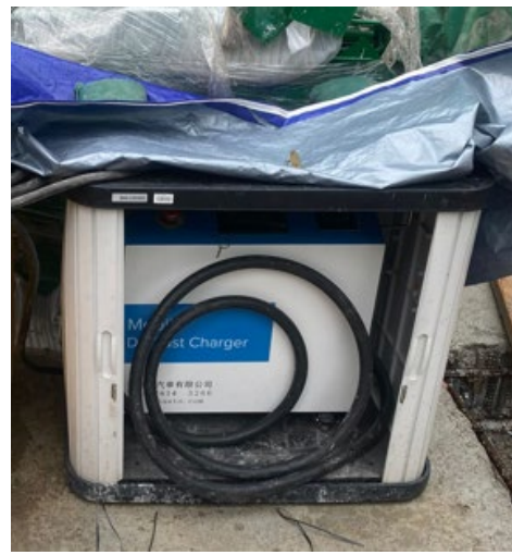
位於啟德沐安街建築地盤的 30 千瓦直流快速充電裝置
