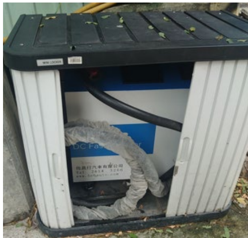
位於屯門顯發里建築地盤的 30 千瓦直流快速充電裝置
