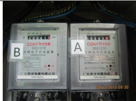
電度表: A 配 EV-1; B 配 EV-2
