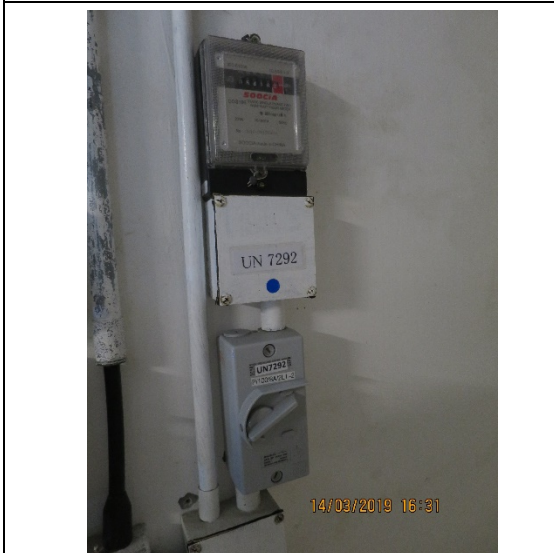
充電裝置連電錶 (科大自資安裝)
